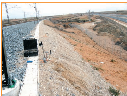
[Fig. 6].- Comprobación de la compactación en un terraplén del AVE a Toledo.
